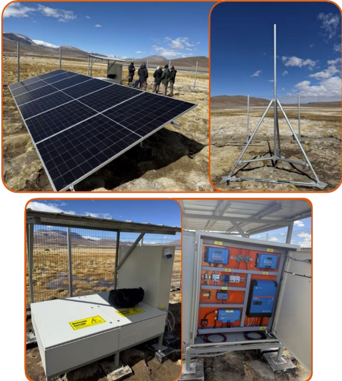
Figura 5.6: Fotografía de la infraestructura instalada entre junio y julio de 2025. Fuente: Carbon Real.
