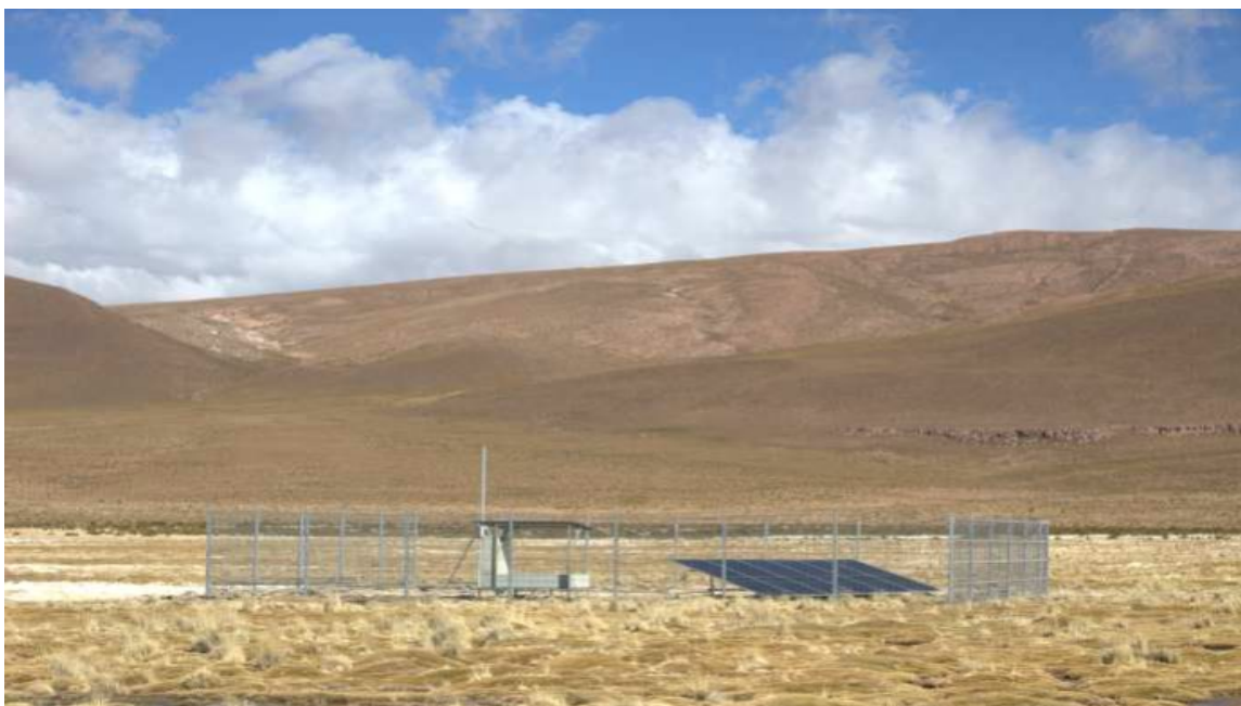
Figura 5.9: Fotografía de la Torre Eddy Covariance y su infraestructura asociada, instalada y en funcionamiento. Fuente: Carbon Real.
